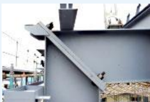
当社がシステム建築に利用する H 型軽量鉄骨
